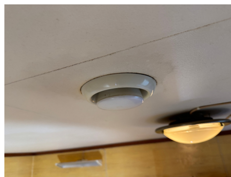
Fuktskade rundt ventil
