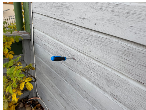
Eksempel på råteskadet kledning
