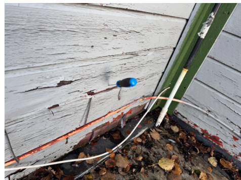
Eksempel på råteskadet kledning
