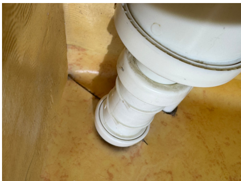
Utetthet ved rørgjennomføring
