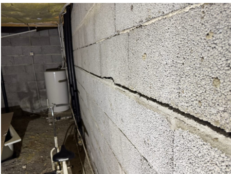
Alvorlig brudd i grunnmur
