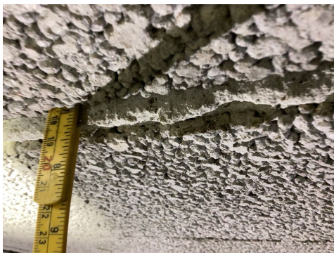
Alvorlig brudd i grunnmur
