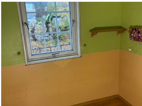
Eksempel på skadet overflate
