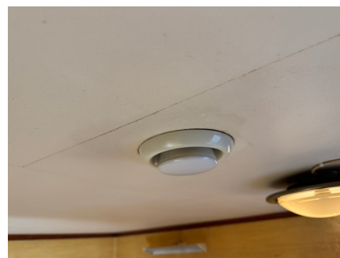
Fuktskadet himling ved ventil i himling
