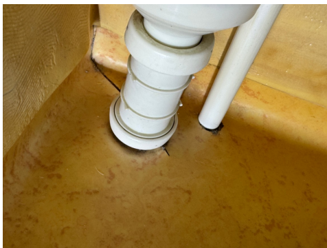
Eksempel på ufagmessig utførelse av hjørner
