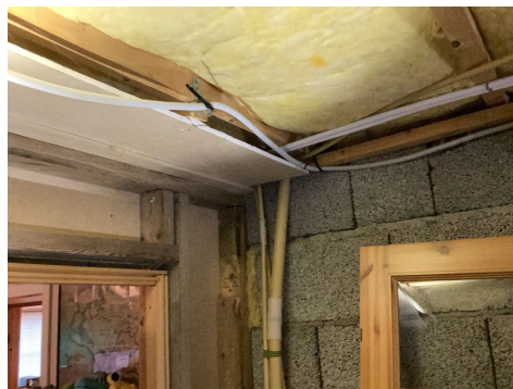
Ikke fagmessig utførelse (eksempel)
