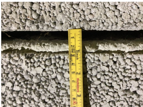
Alvorlig brudd i grunnmur
