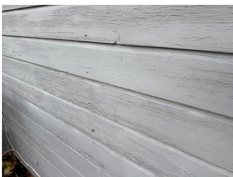
Eksempel på værslitt/opsprukket trepanel
