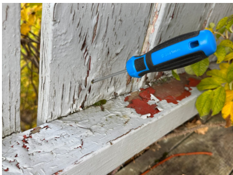
Eksempel på røte i konstruksjonen
