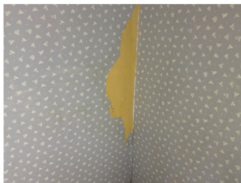
Eksempel på skadet overflate
