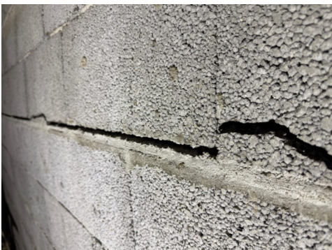
Alvorlig brudd i grunnmur
