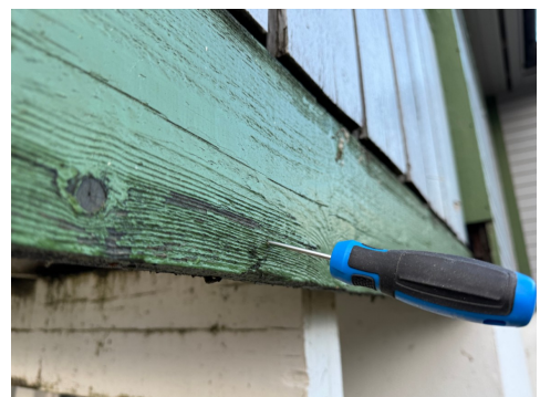
Eksempel på råte i konstruksjonen
