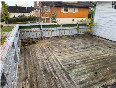
Generelt værslitt/opsprukket trevirke/trepener.
