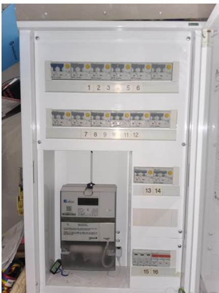
Elektrisk anlegg - [Sikringsskap]
