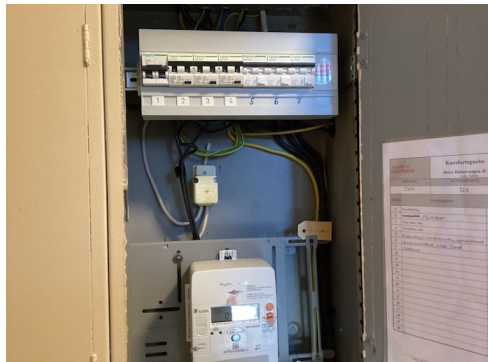
Bilde av sikringskap.
