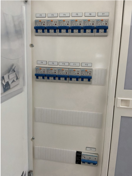
Bilde 7 • Elektrisk anlegg
