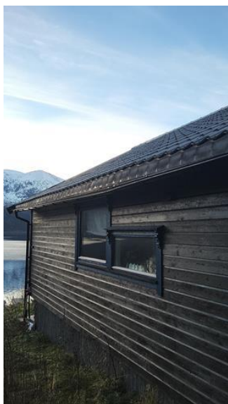
Helhetsvurdering - [Skjevheter i takrenner]
