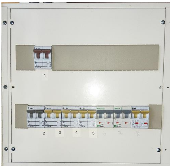
Forenklet vurdering av det elektriske anlegget - [Sikringsskap]
