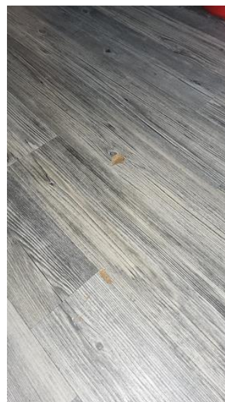
Overflater gulv - [Hakk i stuegulv]
