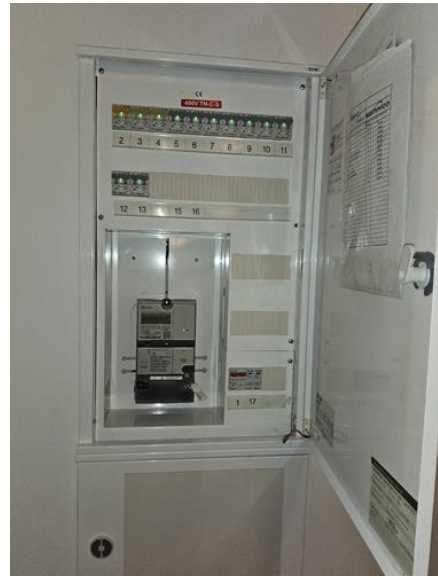
Elektrisk anlegg - [Sikringskap ]
