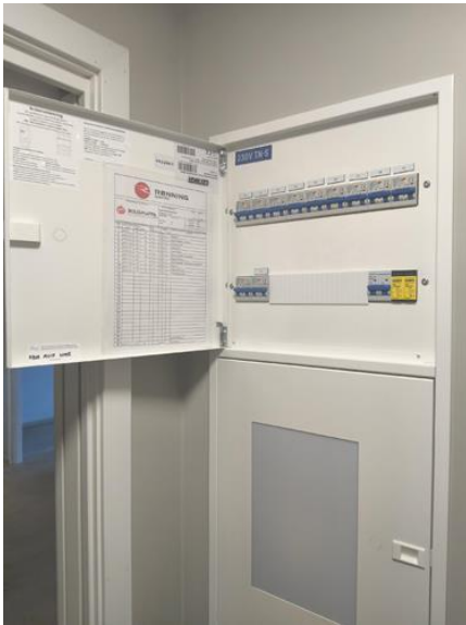
Elektrisk anlegg - [Sikringsskap ]
