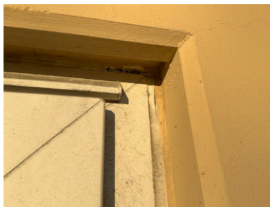
Sprekker i fuge rundt balkongdør.
