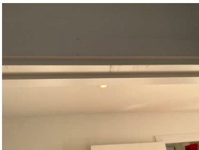
Dørkarm til soverom ved inngang har riper/ skader i overflater.
