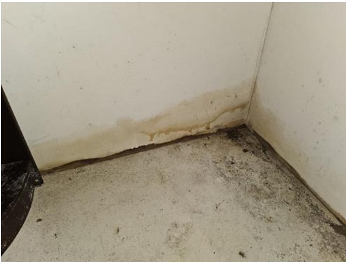
Rom under terreng (kjeller, underetasje, sokkeletasje) - [Synlige fuktskader i utlektet kjellevegg.]
