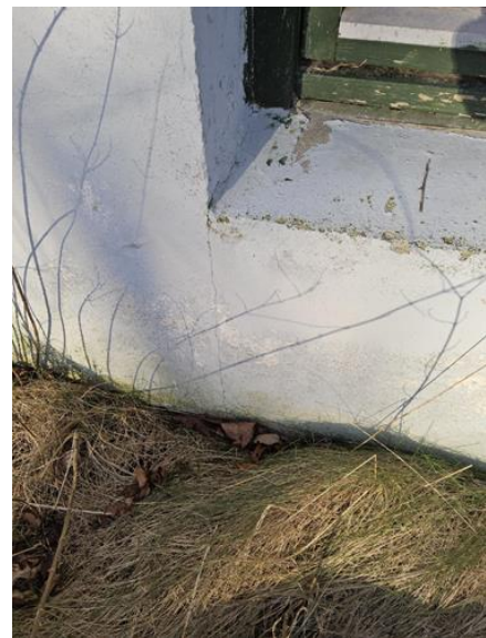
Grunnmur, fundamenter - [Sprekker på grunnmur.]
