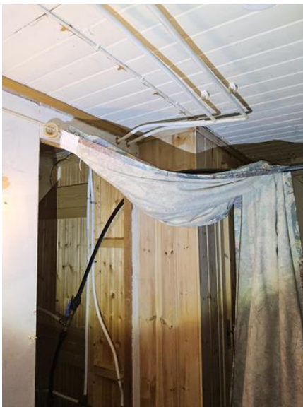
Tekniske anlegg, VVS anlegg (Sjekkpunkter utover det som er inkludert i andre rom) - [Vannrør ikke tilstrekkelig festet.]
