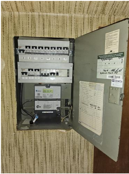
Elektrisk anlegg - [Sikringskap 2.etg.]
