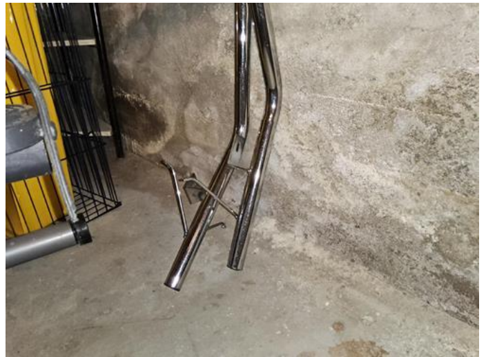
Rom under terreng (kjeller, underetasje, sokkeletasje) - [Sopp og kalkutslag på grunnmur.]
