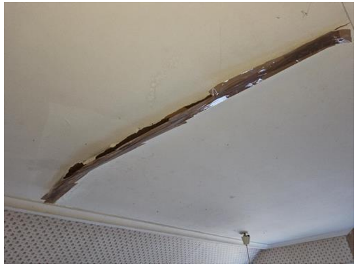
Øvrige rom [eksklusive spesialrom] - [Sprekker i himling soverom 2.etg.]
