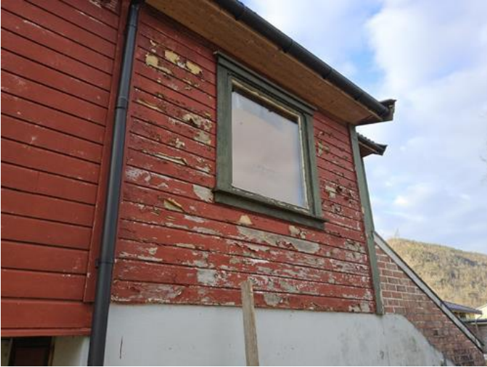
Yttervegger inkl. fasader og konstruksjon - [Høy slitasjegrad på yttervegg.]
