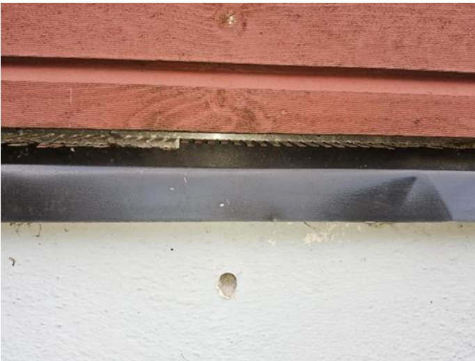
Yttervegger inkl. fasader og konstruksjon - [Åpninger for gnagere.]
