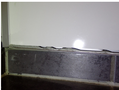
Eksempel på manglende fuging mellom veggplate/bunnlist
