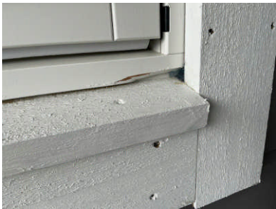
Skade i vinduskarm utvendig.
