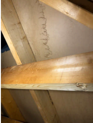
Fuktmerker i undertak.
