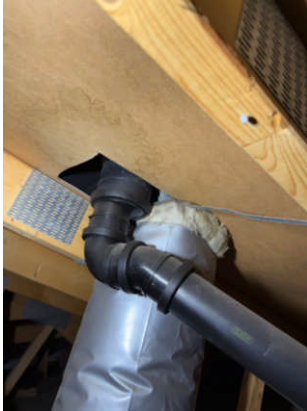
Fuktmerker i undertak ved takgjennomføringer.
