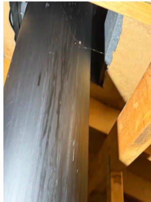
Det er synlige merker etter fukt lags pipe.
