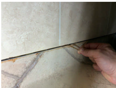
Løs silikon mellom baderomsplate og sokkellist i dusjsone.
