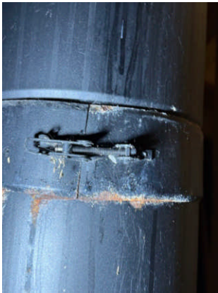
Pipedeler på kaldloft har begynt å ruste. Det anbefales vedlikehold av disse.
