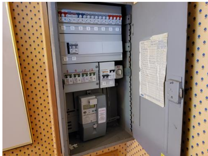
Elektrisk anlegg - [Sikringsskap ]
