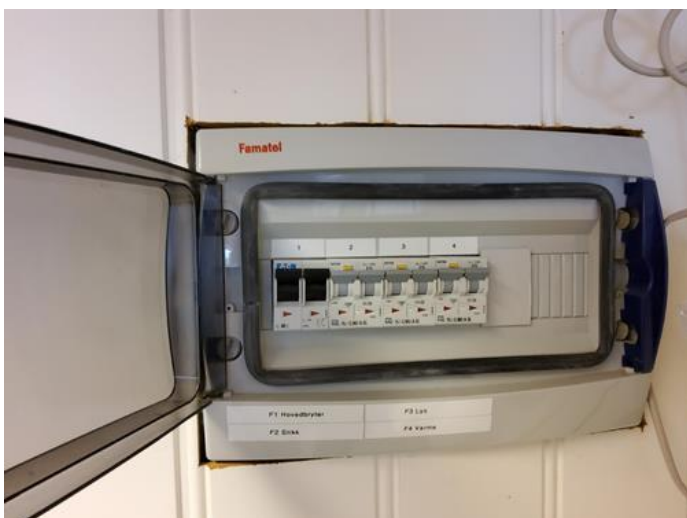
Elektrisk anlegg - [Sikringsskap anneks.]
