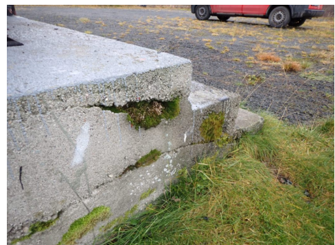
Oppsprekking på siden
