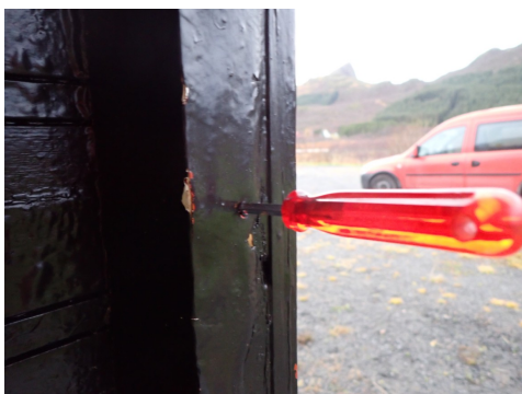
Råte i bæring ved inngang
