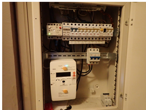
Sikringsskap på loftgang
