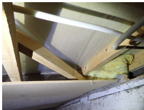
Stedvis manglende isolasjon/platekledning
