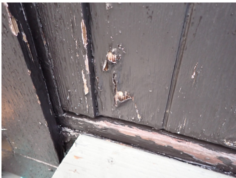
En god del utvendig slitasje på verandadør
