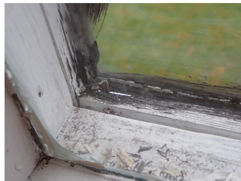
Råte i vindu mot nord
