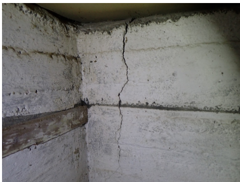
Eksempel på oppsprekking
