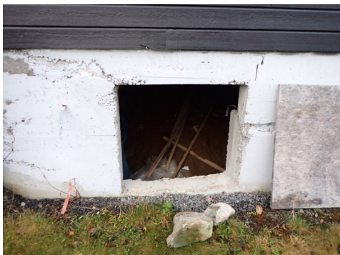
Åpning i mur med løs luke/plate
