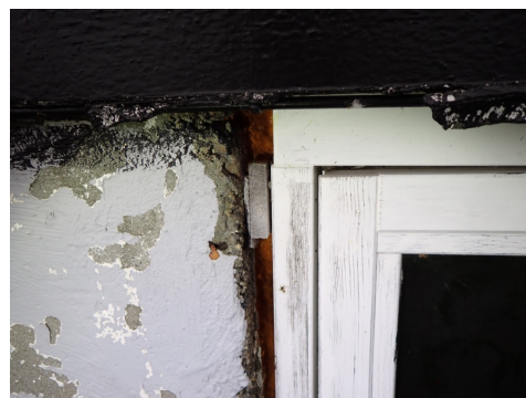
Utvendig omramming er ikke utført
