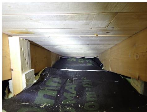
Begrenset/manglende lufting ved raft
