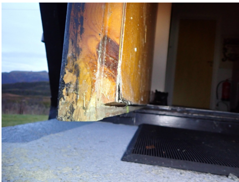
Begynnende fuktskade i underkant av inngangsdør
