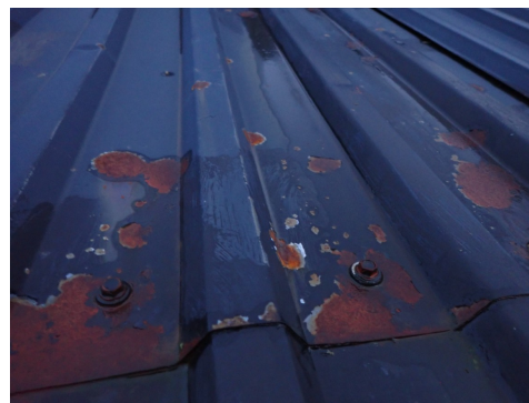
Eksempel på rustflekker
