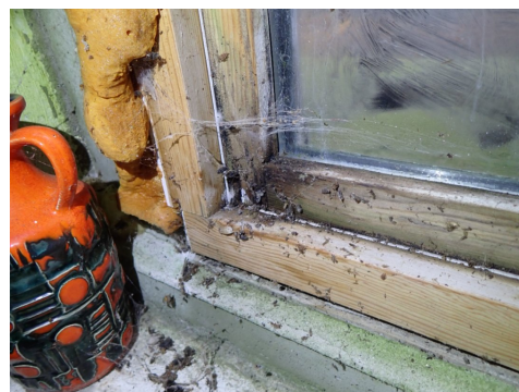
Eksempel på innvendige kondensmerker
