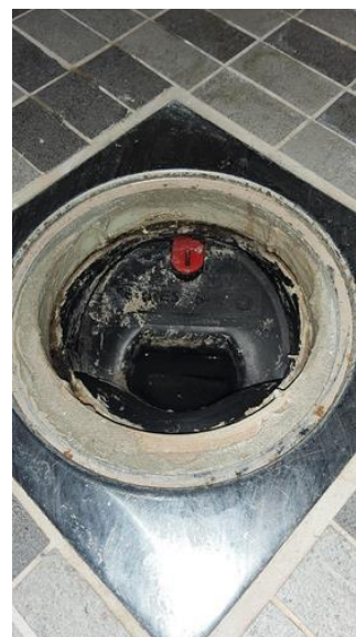
Avløpsrør (ink. sluk) - [Sluk bad 1. etasje]
