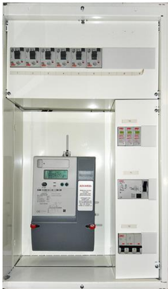
Forenklet vurdering av det elektriske anlegget - [Sikringskap i leilighet]
