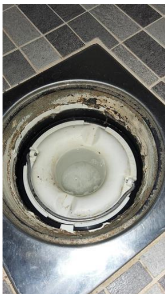
Avløpsrør (ink. sluk) - [Sluk bad 1. etasje i dusj]
