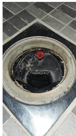
Avløpsrør (ink. sluk) - [Sluk bad 1. etasje]
