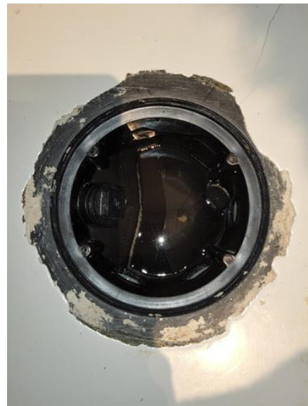
Våtrom - [Sluk vaskerom ]
