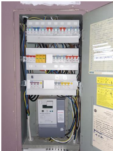
Elektrisk anlegg - [Sikringskap ]
