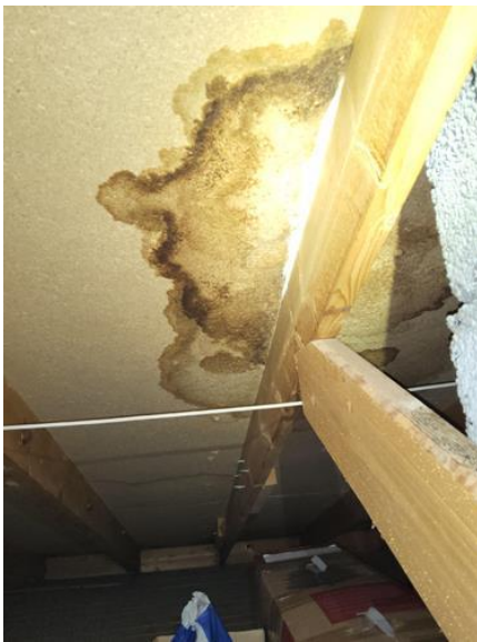
Loft - uinnredet / råloft - [Fuktmerker/ødelagt plate i undertaket ]
