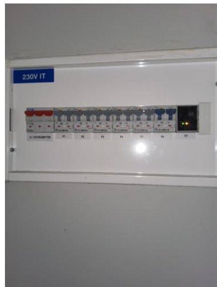
Elektrisk anlegg - [Sikringskap utleiedel ]
