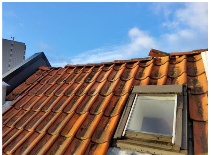
Kommentar - [Takstein på mønet har løsnet og bør festes.]
