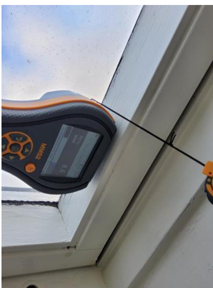
Kommentar - [Fuktmåling takvindu.]
