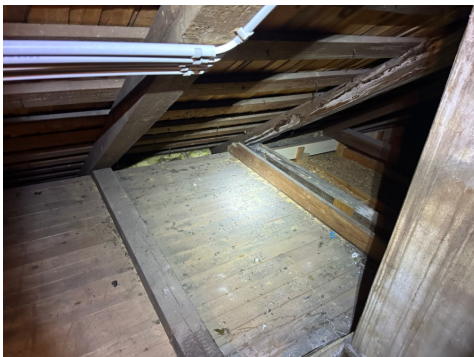
Spor etter fukt gjennomslag i undertak og sperrer.
