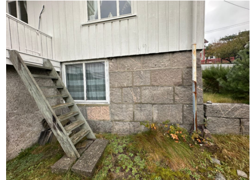
Bratt trapp uten rekkverk.
