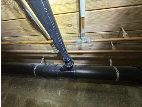
Irr på vannrør i krypkjeller
