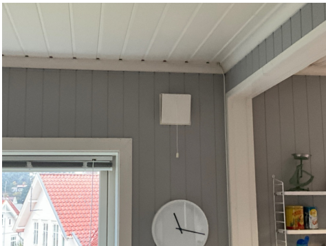
Ventil i vegg i 2 etasje.
