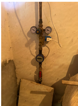
Stoppekran stående ved inntaket i kjeller.
