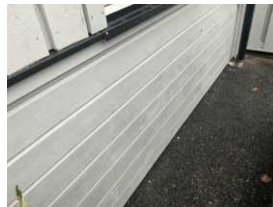
Bilde viser kledning for lang ned mot bakkenivå.
