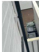
Bilde viser skjevheter i konstruksjonen
