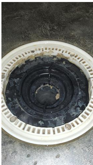
Avløpsrør (ink. sluk) - [Sluk bad 1. etasje]
