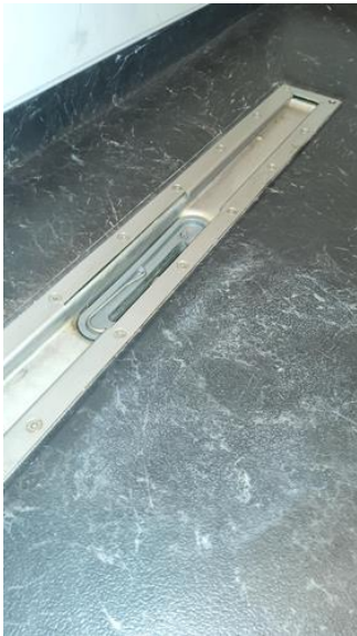
Avløpsrør (ink. sluk) - [Sluk bad 2. etasje]
