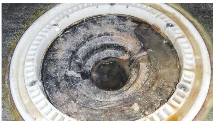
Avløpsrør (ink. sluk) - [Sluk vaskerom]
