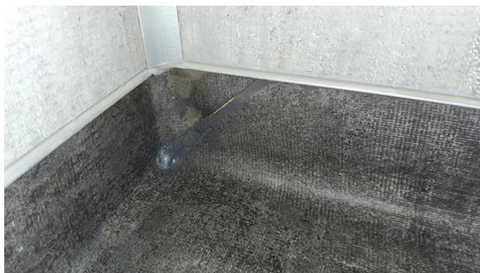
Fallforhold (gulv) - [Utett overgang i belegg bad 1. etasje]
