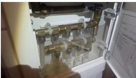
Rørskap med stoppekrane plassert på bad.
