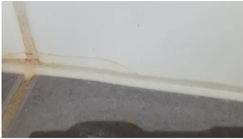
Riss i veggflis i dusjhjørnet.
