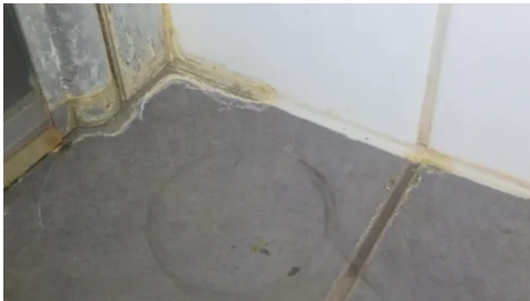
Misfarging i flisefuger i dusjhjørnet.
