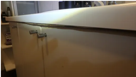
Fuktskade i servantbenk.
