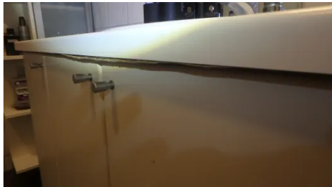
Fuktskade i servantbenk.
