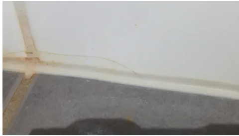
Riss i veggflis i dusjhjørnet.
