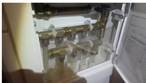
Rørskap med stoppekrane plassert på bad.
