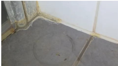
Misfarging i flisefuger i dusjhjørnet.
