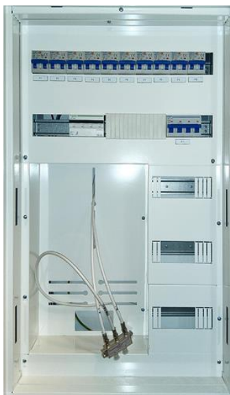
Forenklet vurdering av det elektriske anlegget - [Sikringsskap]
