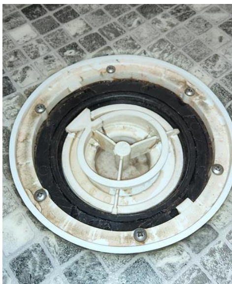
Avløpsrør (ink. sluk) - [Sluk bad]
