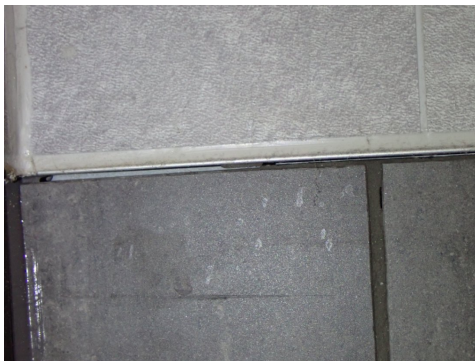
Eksempel på manglende fugging
