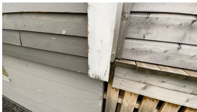
Utsnitt av værslitt kledning.
