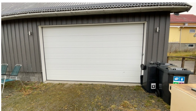
Leddheiseport fra utvendig side.
