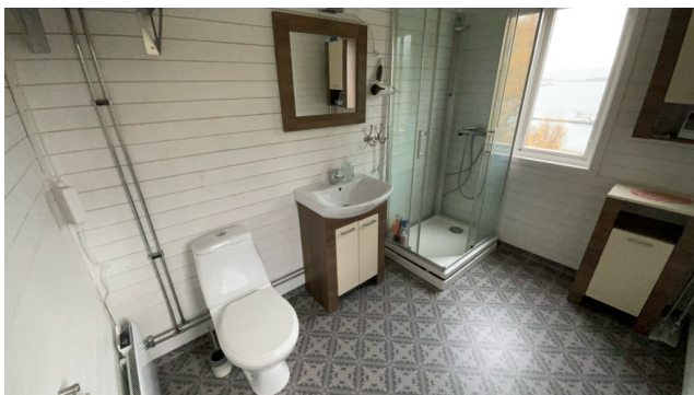
Gulvmontert klosett. Servant på servantskap. Dusjkabinett.
