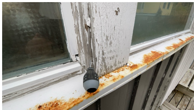
Utsnitt av værslitte vinduer og omramminger - samt råte.
