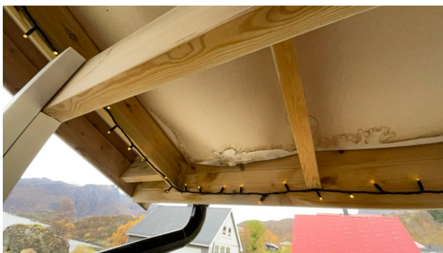
Fuktmerker på undertak ved tak over terrasse.
