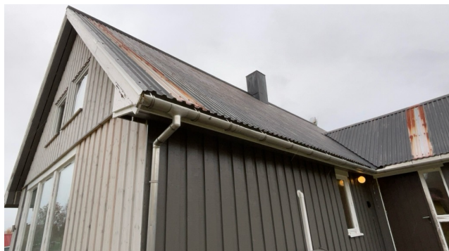
Ingen snøfangere på side mot sørøst.
