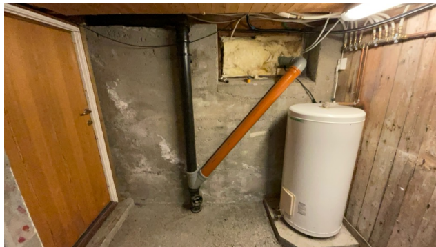
Utsnitt av eksponerte avløpsrør i kjeller.
