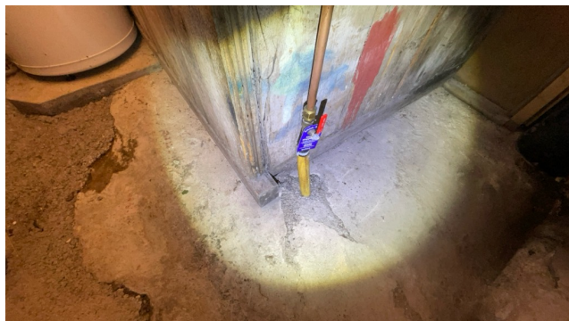
Stoppekran i kjeller.
