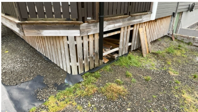
Taknedløp ved fasade mot sørøst avsluttet over terreng uten utkaster.
