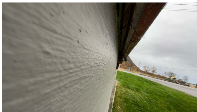
Lite eller ingen lufting av kledning.
