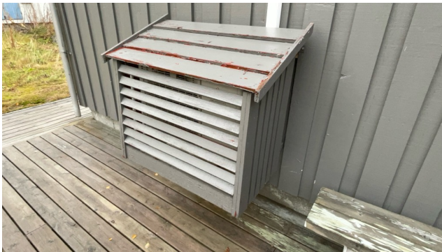
Varmepumpe - utedel montert på fasade mot sørøst.
