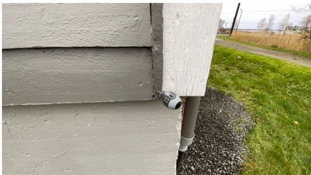
Utsnitt av råteskadd kledning.
