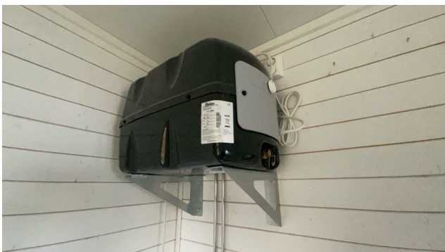
Varmtvannstank montert på vegg på badetrom.
