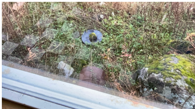
Septikbeholder ved bolig 2.
