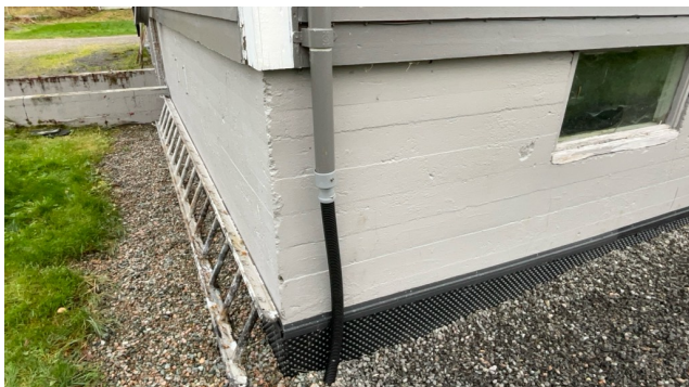
Taknedløp tilknyttet slange til grunnen ved faade mot nordvest.
