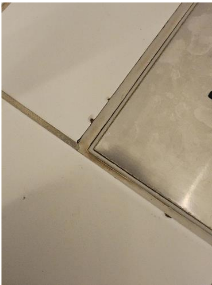
Våtrom - [Skader på gulvfliser i dusjsonen. ]
