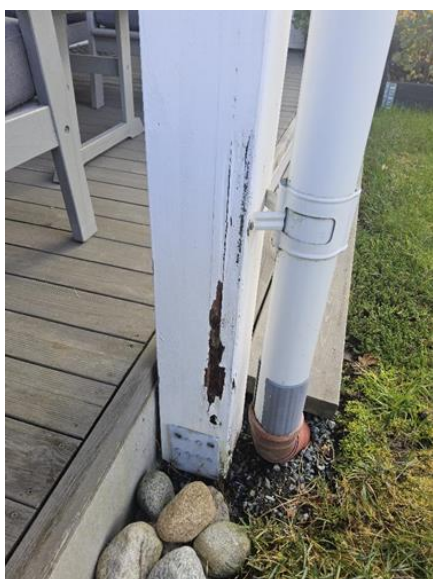
Balkonger, terrasser, veranda etc - [Råteskader på søyle.]
