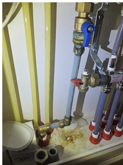
Våtrom - [Korrosjon på vannrør i kombiskap. ]
