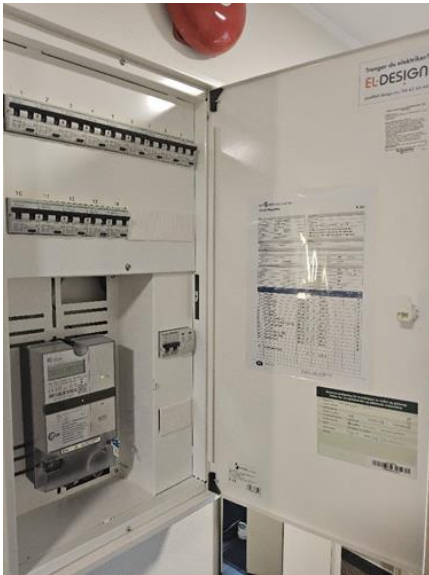
Elektrisk anlegg - [Sikringsskap. ]
