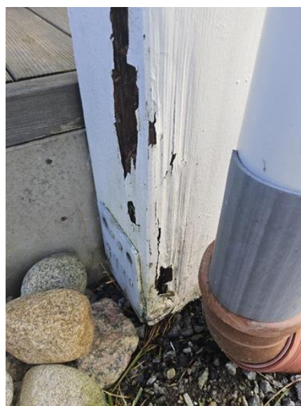
Balkonger, terrasser, veranda etc - [Råteskader på søyle.]
