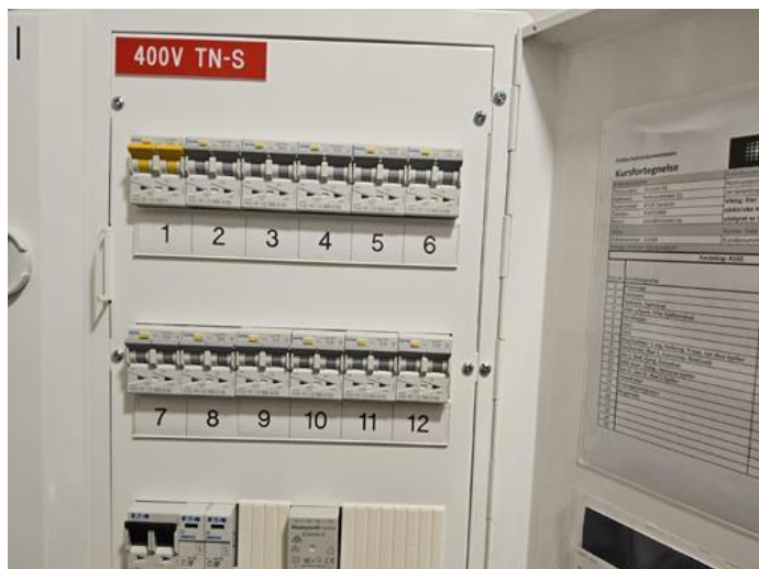
Elektrisk anlegg - [El-skap.]
