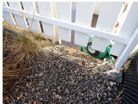
Stedvis åpninger mellom mur og gjerde
