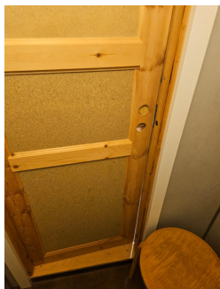
Innvendig dør mellom omkleddingsrom og dusjrom mangler dørvrider.
