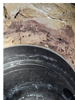
Nærbilde av overgang mellom sluk og påstøp. Sprekkdannelser i påstøp.
