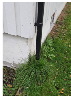
Taknedløp mangler utkast for bortledning av vann.
