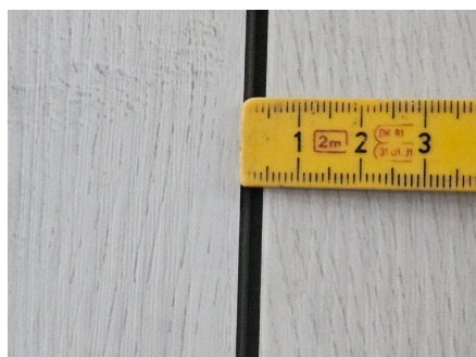
Åpen skjøt i laminatgulv (hoveddel).
