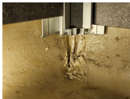
Sprekkdannelser i hjørnesveis.
