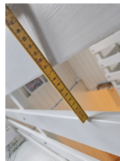
Målt åpning i rekkverk 2. etasje.
