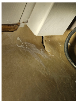
Sprekkdannelse i gulvbelegget ved dørterskel.
