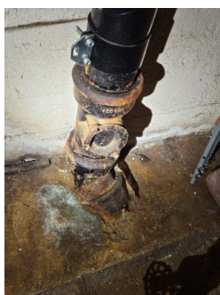
Rustskader på avløpsrør av støpejern.
