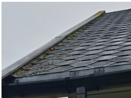
Takfotbeslag mangler på østsiden av hovedbygget.
