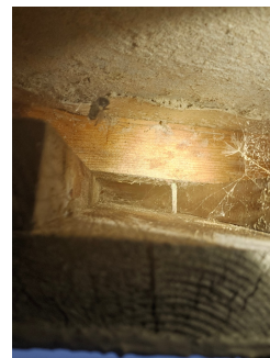
Ingen synlig gnagersikring bak bordkledning.
