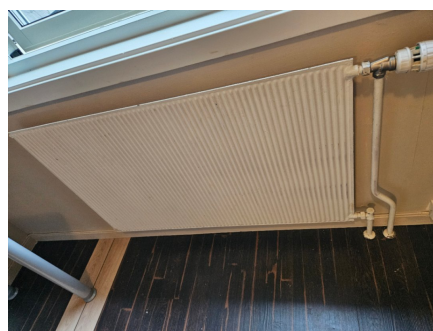
Vegghengt radiator av eldre type.
