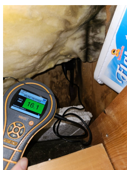
Fuktmåling i misfarget takkonstruksjon (takutstikk mot øst).
