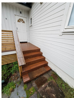
Trappeløpet mangler håndløper på vegg.
