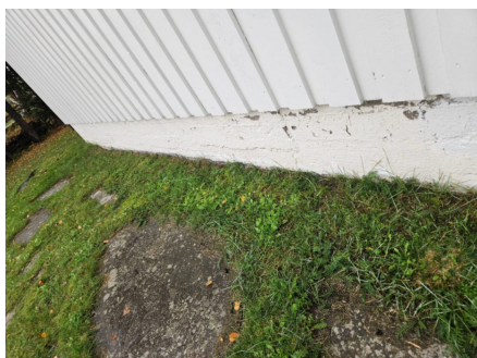
Noe flassende maling på grunnmurens utvendige overflate.
