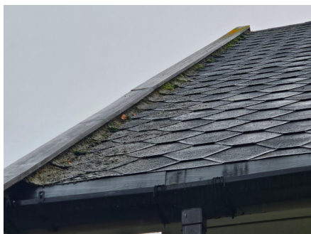
Mosevekst på takoverflaten.
