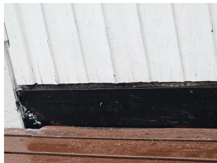
Tørkesprekker i balkongdør.
