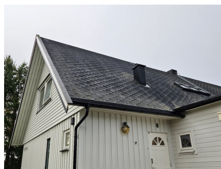
Det er risiko for snø- og isras fra taket på boligens hoveddel.
