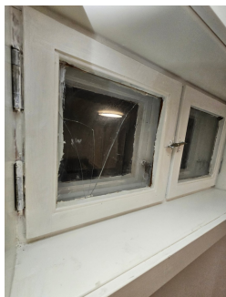
Sprekk i innvendig glassrute i kjelleren.
