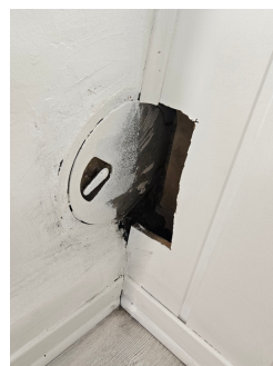
Sotluke tett plassert mot brennbart materiale.
