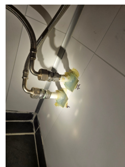
Rørgjennomføringer i våtsone for dusj.
