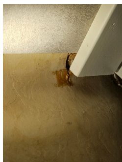
Sprekkdannelser i gulv (våtzone)
