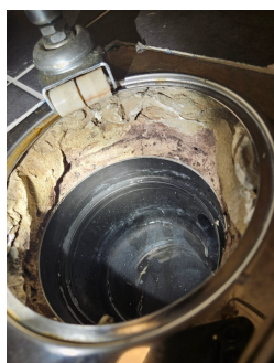
Ingen synlig bruk av membran/mansjett i sluk.
