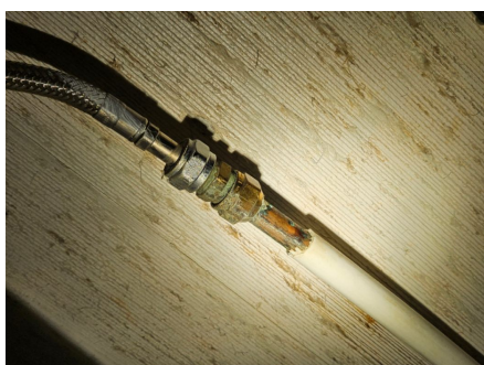
Irring på synlig vannrør.
