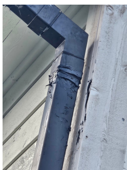
Provisorisk utbedring av taknedløp.
