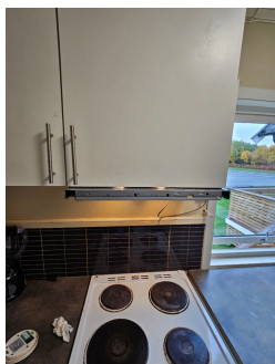
Ventilator mangler frontdeksel.
