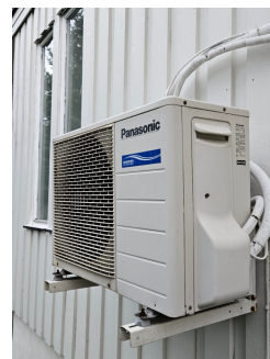
Varmepumpens utvendige del.
