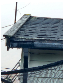
Mosevekst på takoverflaten mot sør.
