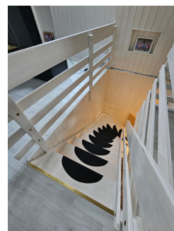
Trappeløpet mellom første og andre etasje mangler håndløper på vegg.
