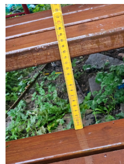
Målt åpning mellom trappetrinn.
