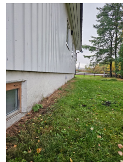
Lite/ingen fall ut fra grunnmur.
