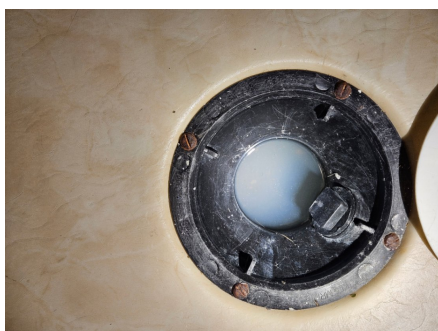
Sluk har rustskader i metalldetaljer.
