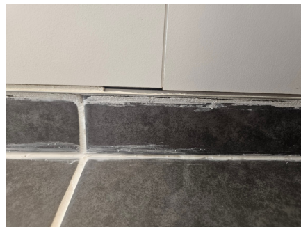
Delvis manglende fuge mellom sokkelfprofil og veggplate. I tillegg er det brukt flisfuge der fugging er utført.
