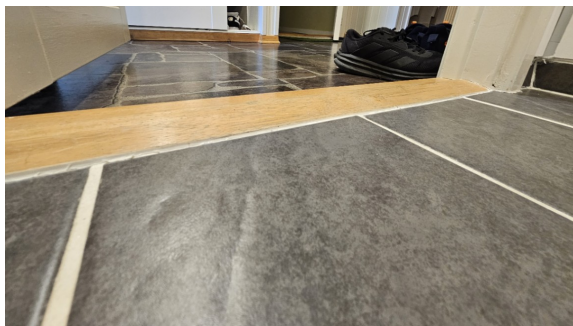
Ingen membranoppkant ved dørterskel.
