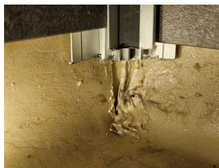
Sprekkdannelser i gulv (våtzone)
