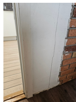
Sprekkdannelse i vegg mellom kjøkken-stue i tilbygget.
