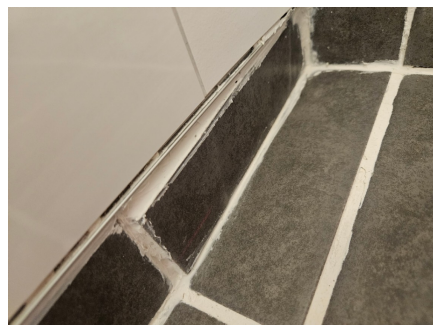
Veggoverflaten går fra å flukte med sokkelflisen til å stikke utenfor.
