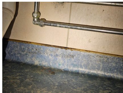
Svertesopp på silikonfuge.
