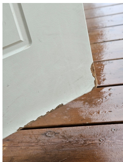
Fuktskader/svelling i hoveddør.
