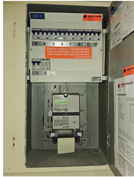
Elektrisk anlegg - [Sikringskap]
