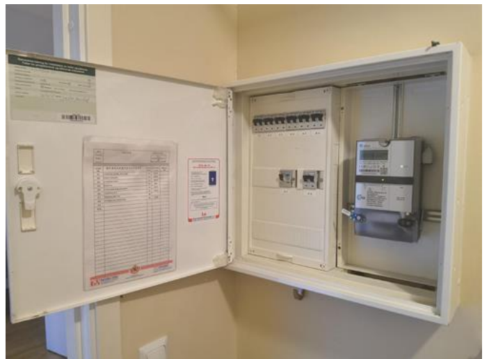
Elektrisk anlegg - [Sikringskap ]
