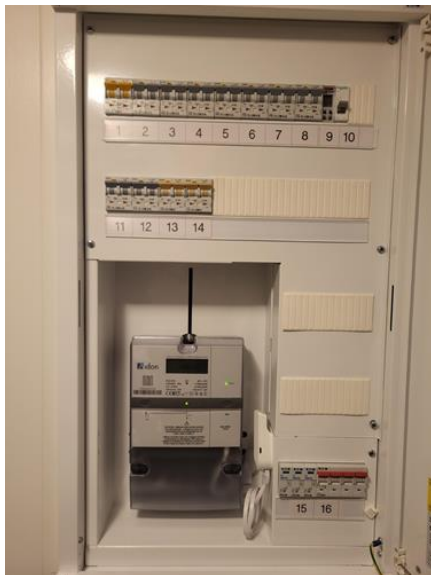
Elektrisk anlegg - [Sikringskap]
