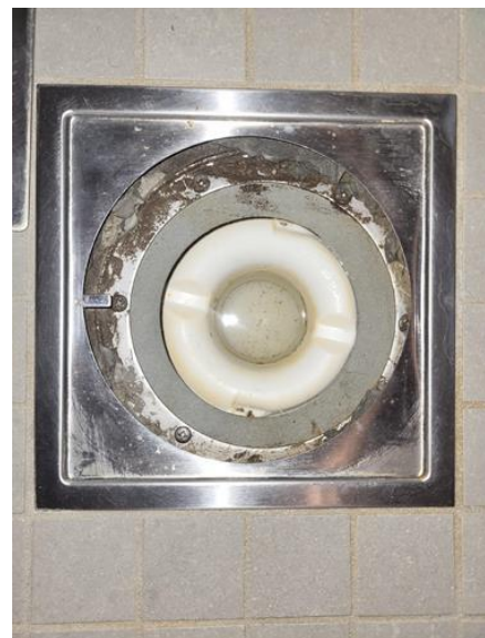
Våtrom - [Sluk på bad]
