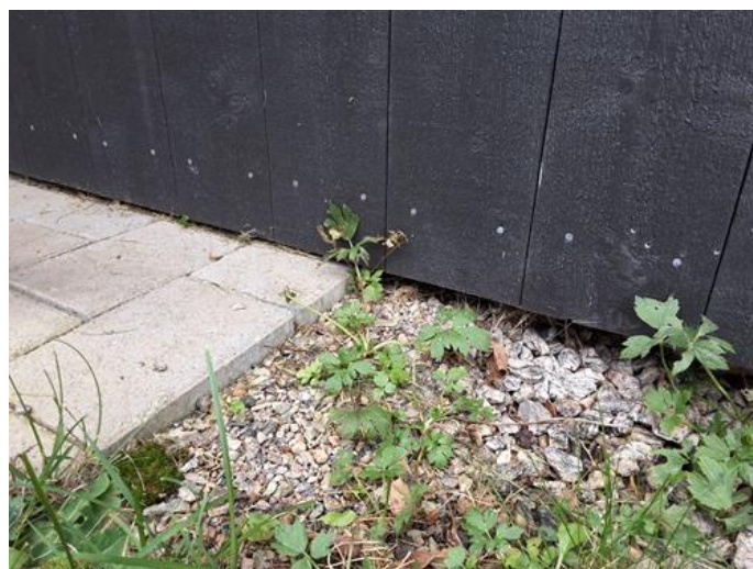
Utvendig - [Liten klaring mellom terreng og kledning]
