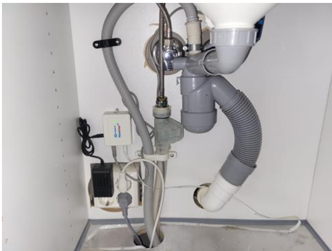
Kjøkkenen - [Rørøpplegg i kjøkkenbenk]
