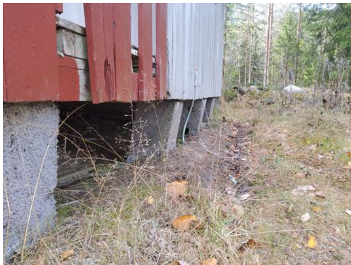
Frittstående byggverk - [Skjevheter i søyler til anneks]
