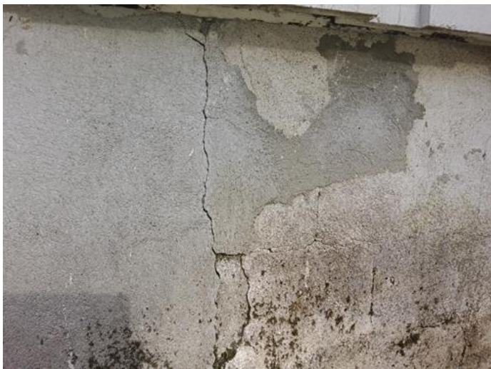
Grunnmur, fundamenter - [Eksempel på sprekker og avskalling på grunnmur]
