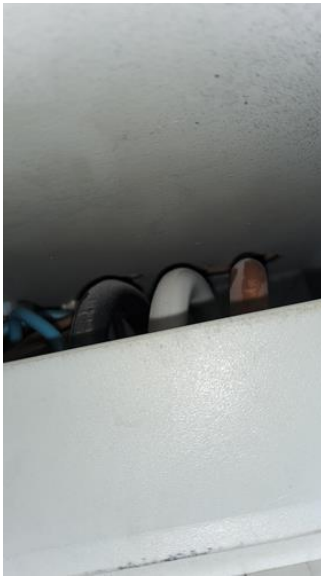
Forenklet vurdering av det elektriske anlegget - [Utettheter i sikringskap i overkant]
