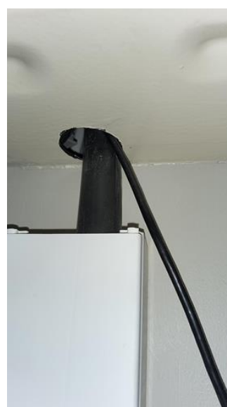
Forenklet vurdering av det elektriske anlegget - [Utettheter i sikringssskap i underkant]
