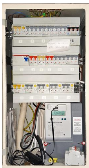
Forenklet vurdering av det elektriske anlegget - [Sikringssskap]
