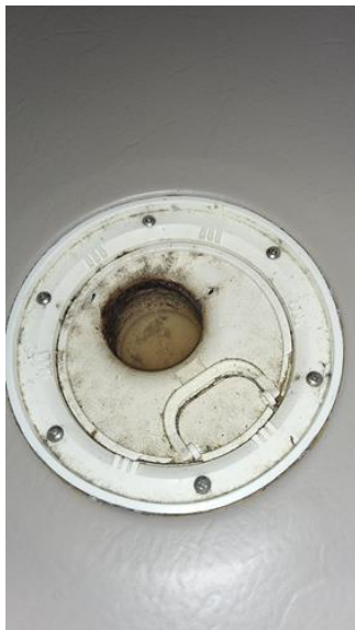
Avløpsrør (ink. sluk) - [Sluk bad 1. etasje]
