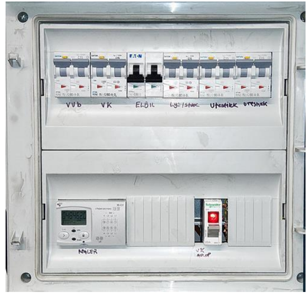
Forenklet vurdering av det elektriske anlegget - [Sikringskap i garasje]
