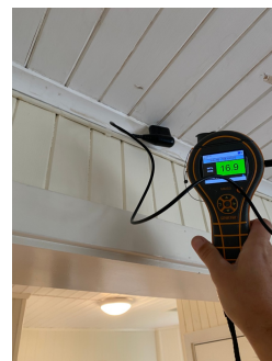
Forhøyet fuktverdi under balkong
