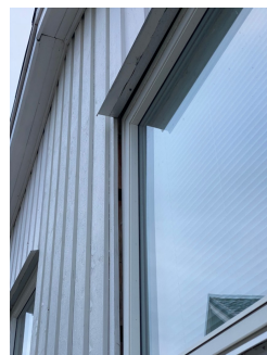
Ufagmessig montasje av ett vindu
