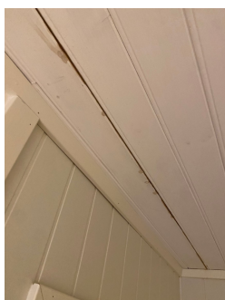
Fuktmerker i himling i gangen i 2 etasje etter lekkasje
