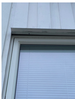
Ufagmessig montasje av ett vindu
