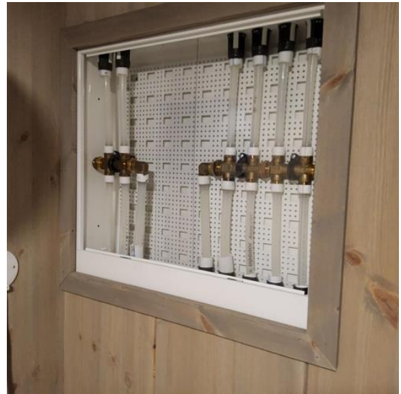
Innvendig - [Fordelerskap for rør-i-rør system plassert i bod underetasje]
