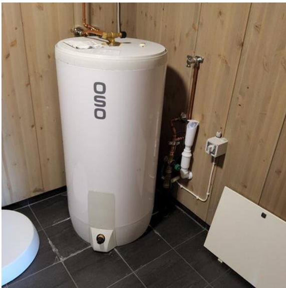
Innvendig - [Varmtvannsbereder, hovedstoppekran og opplegg for vaskemaskin i bod underetasje. Fuktskjolder på gul]
