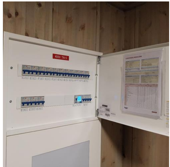
Elektrisk anlegg - [Sikringsskap og kursoversikt]
