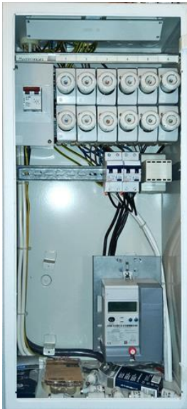
Forenklet vurdering av det elektriske anlegget - [Sikringsskap]
