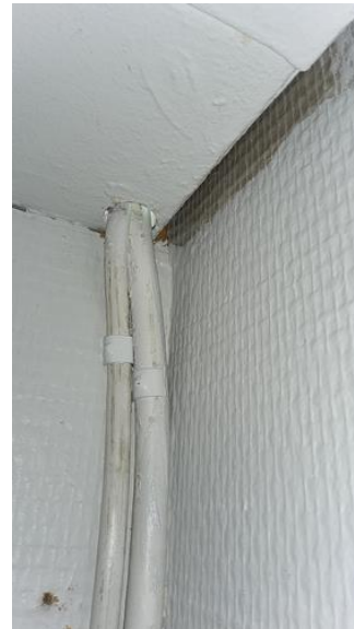
Forenklet vurdering av det elektriske anlegget - [Utettheter i sikingsskap]
