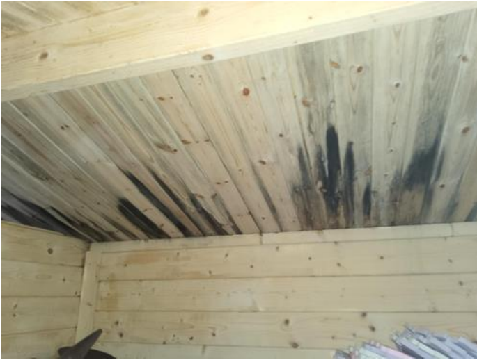
Frittstående byggverk - [Fuktskader i himling i frittstående utebod på balkong mot nord.]
