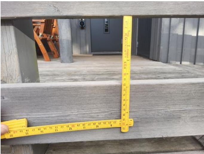
Balkonger, terrasser, veranda etc - [Lysåpning mellom rekkverksbord på balkong mot sydvest.]
