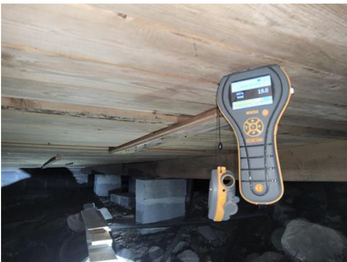
Innvendig inspeksjon - [Fuktmåling i himling i krypkjeller]
