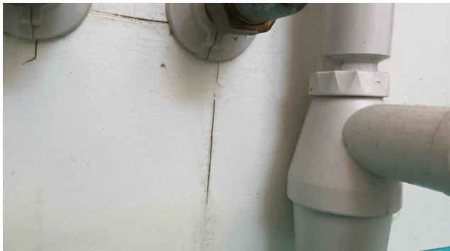
sprekk i belegg skjøyter
