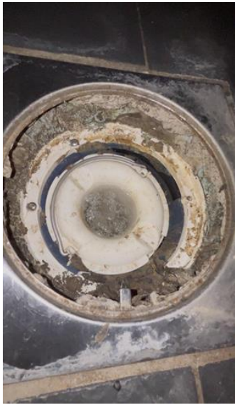
Avløpsrør (ink. sluk) - [Sluk bad]
