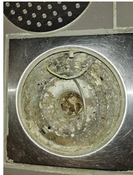
Avløpsrør (ink. sluk) - [Sluk vaskerom]
