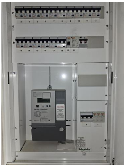
Elektrisk anlegg - [Sikringskap]
