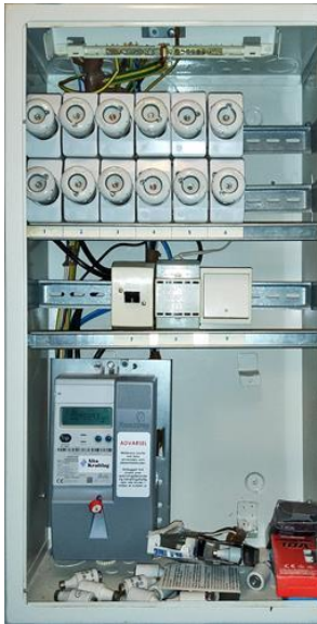
Forenklet vurdering av det elektriske anlegget - [Sikringsskap]
