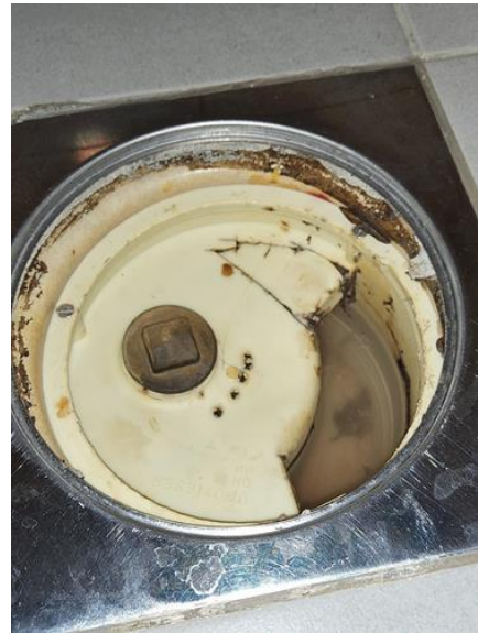
Avløpsrør (ink. sluk) - [Sluk bad]
