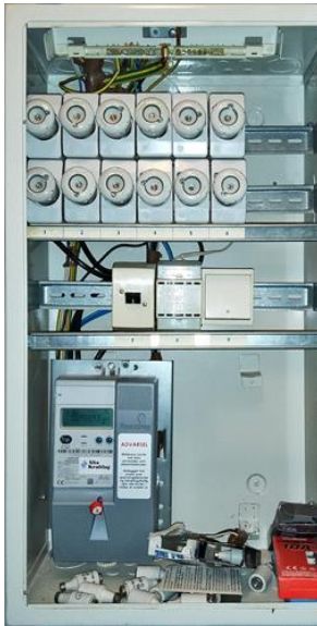
Forenklet vurdering av det elektriske anlegget - [Sikringsskap]
