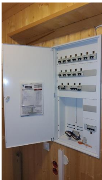
Elektrisk anlegg - [Sikringsskap]
