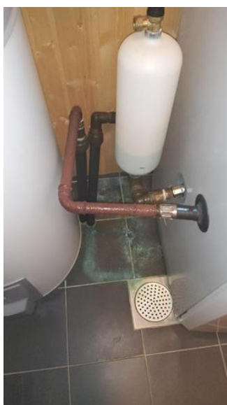
Varmesentral (eksempelvis fyrkjele, varmepumpe, fjernvarme, pelletsanlegg, gasskjel etc.) - [Kondens inntaksrør/varmesentral]
