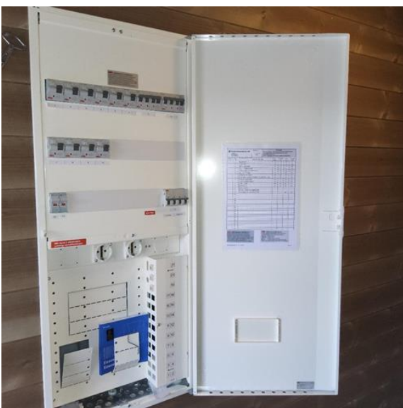
Elektrisk anlegg - [Sikringsskap og kursoversikt]
