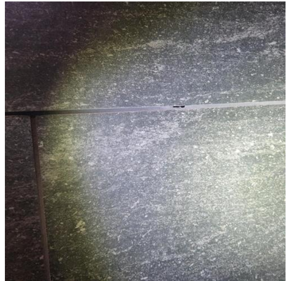
Overflater vegger - [Hull i flisfuge i dusjsonen bad ved badstue]
