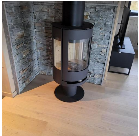
Innvendig - [Ubrennbar plate på gulv ved peisovn må etableres]
