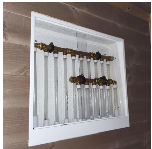
Innvendig - [Fordelerskap for rør-i-rør system plassert i utvendig bod]
