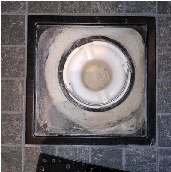
Avløpsrør (ink. sluk) - [Sluk bad ved badstue]
