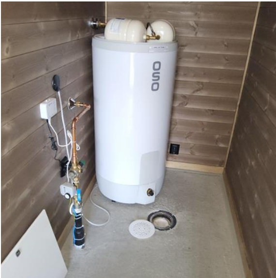
Innvendig - [Varmtvannsbereder og hovedstoppekran plassert i utvendig bod]
