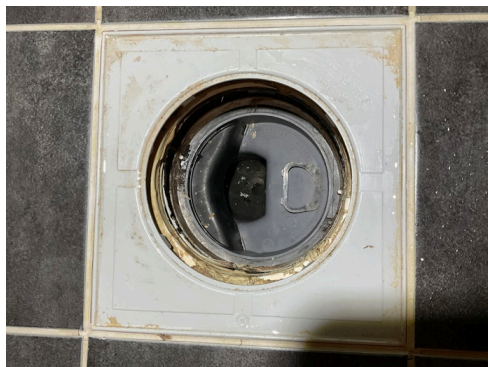
Sluk i dusjsone.
