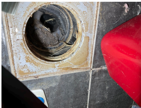
Sluk utpå gulv, ved varmtvannsbereder.
