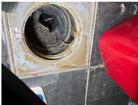
Sluk utpå gulv, ved varmtvannsbereder.
