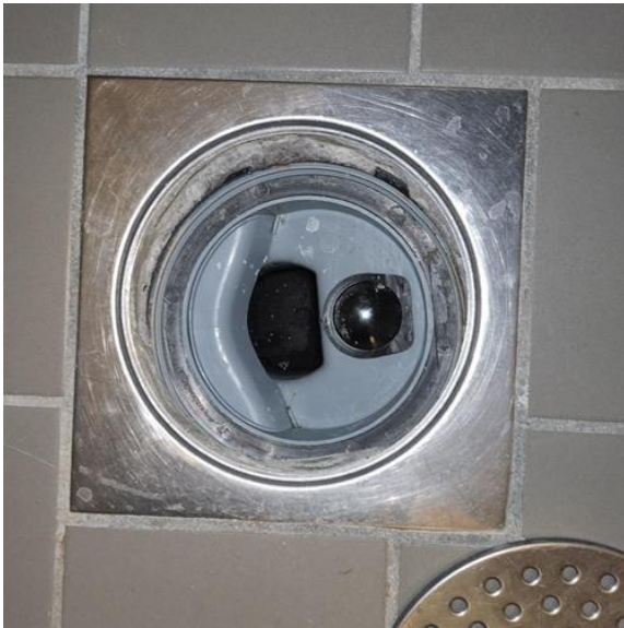
Avløpsrør (ink. sluk) - [Sluk vaskerom]
