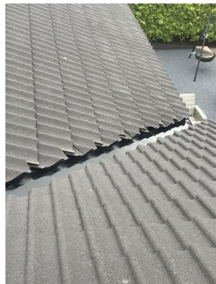
Utvendig - [Eksempel på knekte taksteiner i gradrenne]
