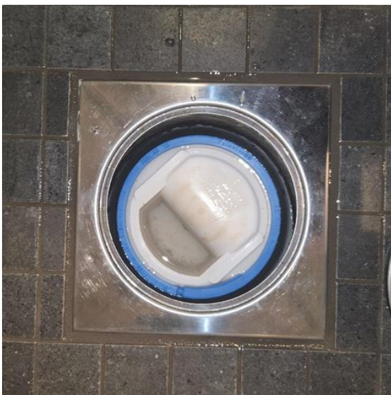
Avløpsrør (ink. sluk) - [Sluk bad]
