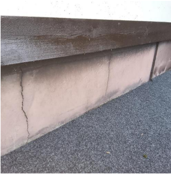
Utvendig - [Eksempel på sprekker i ringmurselementer ved stor platting]
