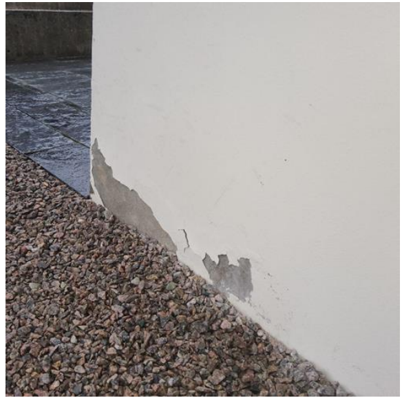
Utvendig - [Eksempel på overflateslitasjer på yttervegg av betong]
