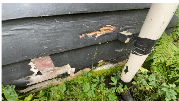
Det er råte i nedre del av vegg ved taknedløp og manglende ventilering. Synlig skade på asfaltplate.
