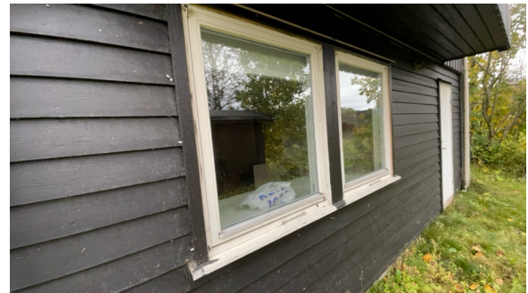
Vindu på kjøkken
