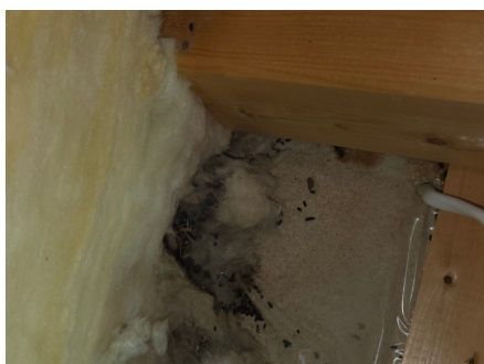
Det registreres ekskrementer etter mus på kryploft/kaldloft
