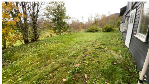
Dårlig fall på terreng foran boligen
