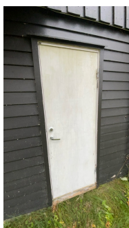
Boddør. Mangler beslag under terskel
