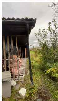
Søyle ved garasje har skjevheter som følge av svakt fundament
