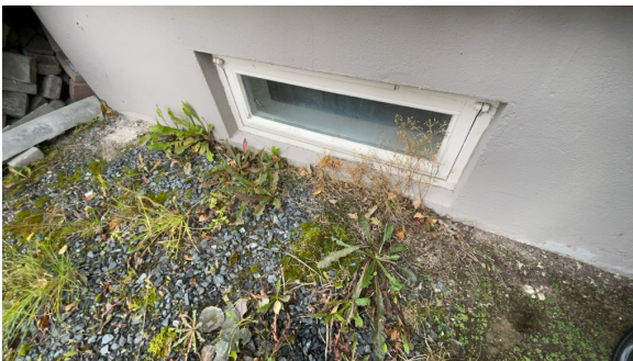
Vindu på bad er punktert
