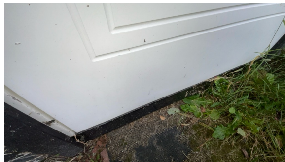
Er noe svelling i nedre del av dørblad på hoveddør
