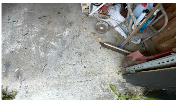
Sprekk i betonggulv
