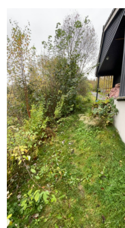
Impregneret rekkverk /støtte ned langs siden på garasje/bod er svak.
