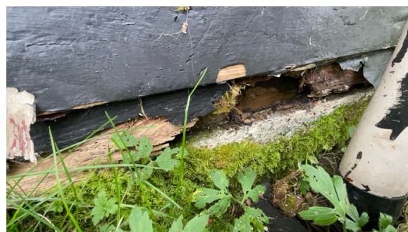
Det er råte i nedre del av vegg ved taknedløp og manglende ventilering. Synlig skade på asfaltplate.
