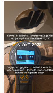
Kontroll av bunnvill i innforet yttervegg på stue mot øvre hjørne. Det er målt 13,7%. Veggene er bygget opp med lettklinkerblokk, forhudningspapp, luftespalte, isolasjon/lekter, dampsperre og malte plater
