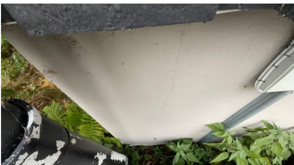
Små riss i puss
