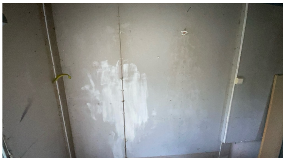
Skjøter på gipsplater er ikke tette
