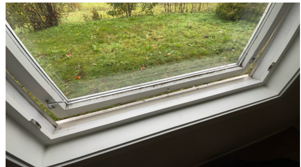
Mugg i nedre del av vindu på soverom
