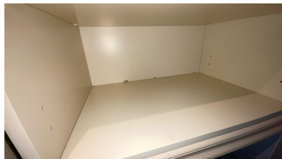
Små skader i hylle på veggen.
